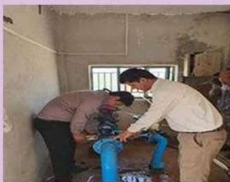
نصب کنتور حجمی در محل مجتمع صادق آباد شهرستان جاجریم
